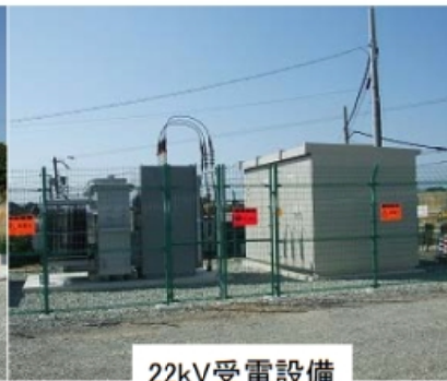
22kV受電設備
