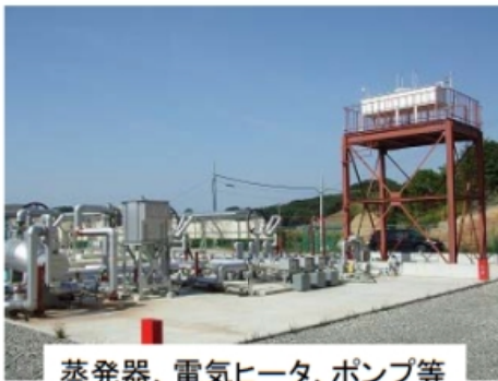
蒸発器、電気ヒータ、ポンプ等
