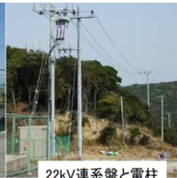
22kV連系盤と電柱
