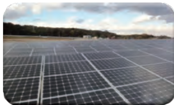
住民参加型くにうみ太陽光発電所 (1 MW)
